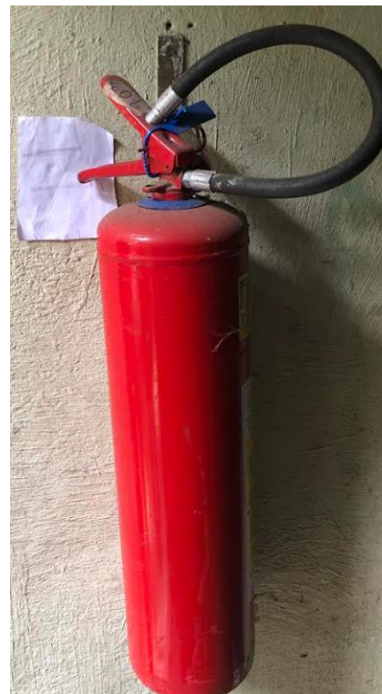
Campo de São Bento – 1 Co 2 - Casa de Força
